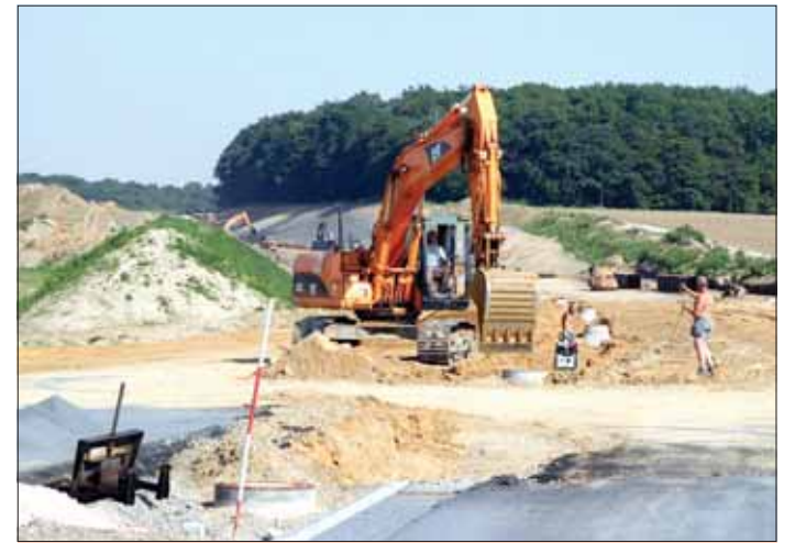
Die Fertigstellung der A39 bis Cremlingen ist bis Ende des Jahres geplant. Foto: Alexander Gräbner
