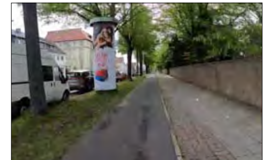
Am Hauptfriedhof muss der Radweg breiter und saniert werden.
