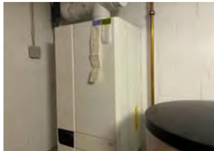
Bei vielen steht nach etwa 20 Jahren der Austausch der Gasheizung an.
